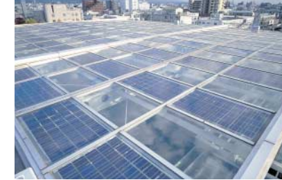
ローム本社 太陽光発電施設 年間1万1千kwhの 発電能力
