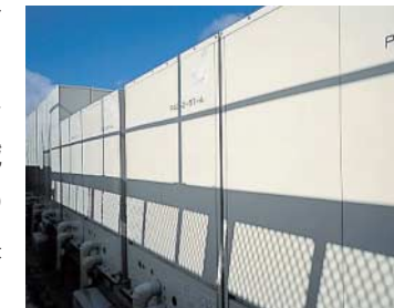
氷蓄熱空調システム
