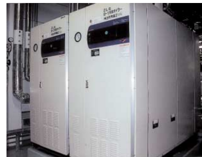
天然ガスボイラー
