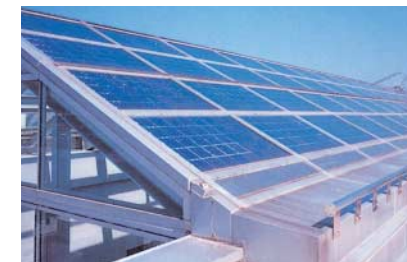
ローム福岡 太陽光発電施設 年間2万2千kwhの 発電能力
