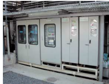
排水連続監視装置
