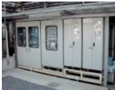
排水連続監視装置
