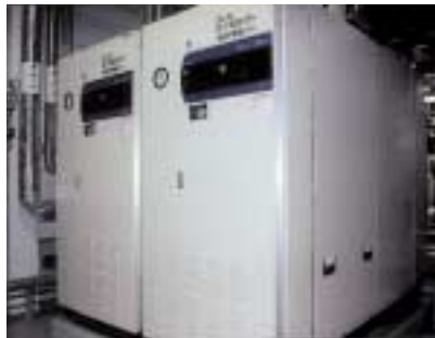
天然ガスボイラー
