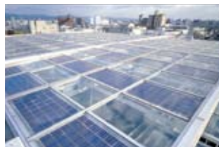
ローム本社 太陽光発電施設 年間1万1千kwhの発電能力
