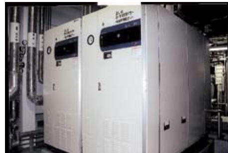
天然ガスボイラー
