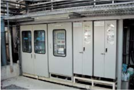
排水連続監視装置
