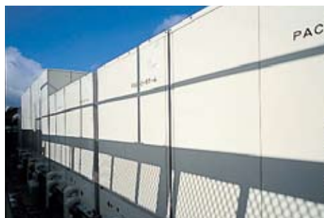
氷蓄熱空調システム
