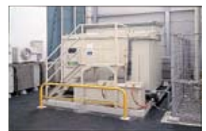
ローム本社に設置した生ごみ消滅処理施設
