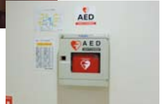
AED設置事例
