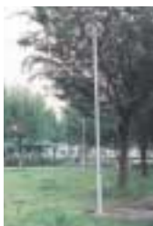
増設された水銀灯により夜も明るくなりました。
