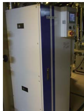
VOC除害装置
