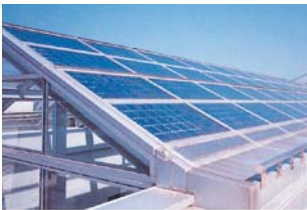
ローム福岡 太陽光発電施設 年間2万2千kwhの発電能力
