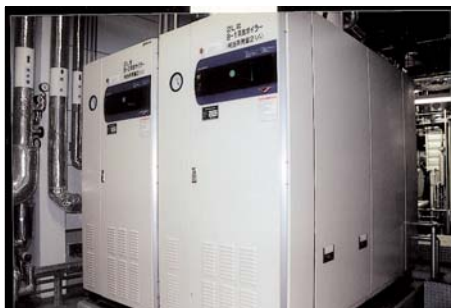
天然ガスボイラー
