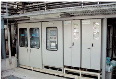
排水連続監視装置
