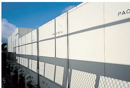
氷蓄熱空調システム
