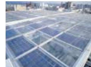
ローム本社太陽光発電施設 年間1万1千kwhの発電能力
