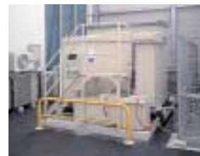
ローム本社に設置した生ごみ消滅処理施設
