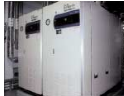
天然ガスボイラー
