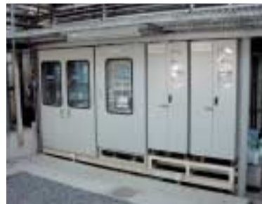
排水連続監視装置
