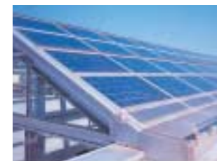
ローム福岡太陽光発電施設 年間2万2千kwhの発電能力
