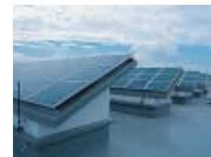
ローム・アポロ太陽光発電施設 年間2万4千kwhの発電能力
